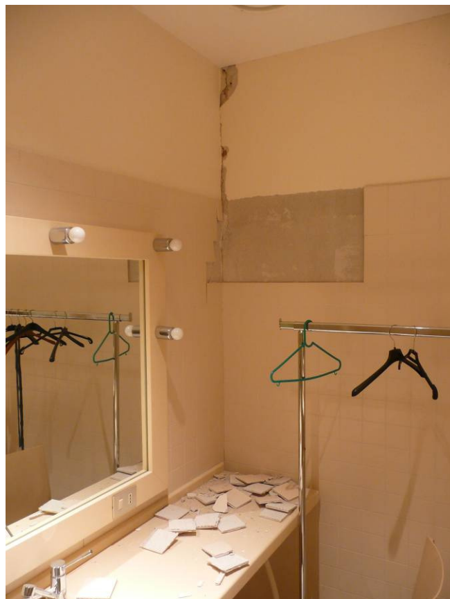
Un Camerino del Teatro, dopo il sisma del 29 Maggio
